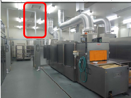
洗浄室空調設備（吹出口）
