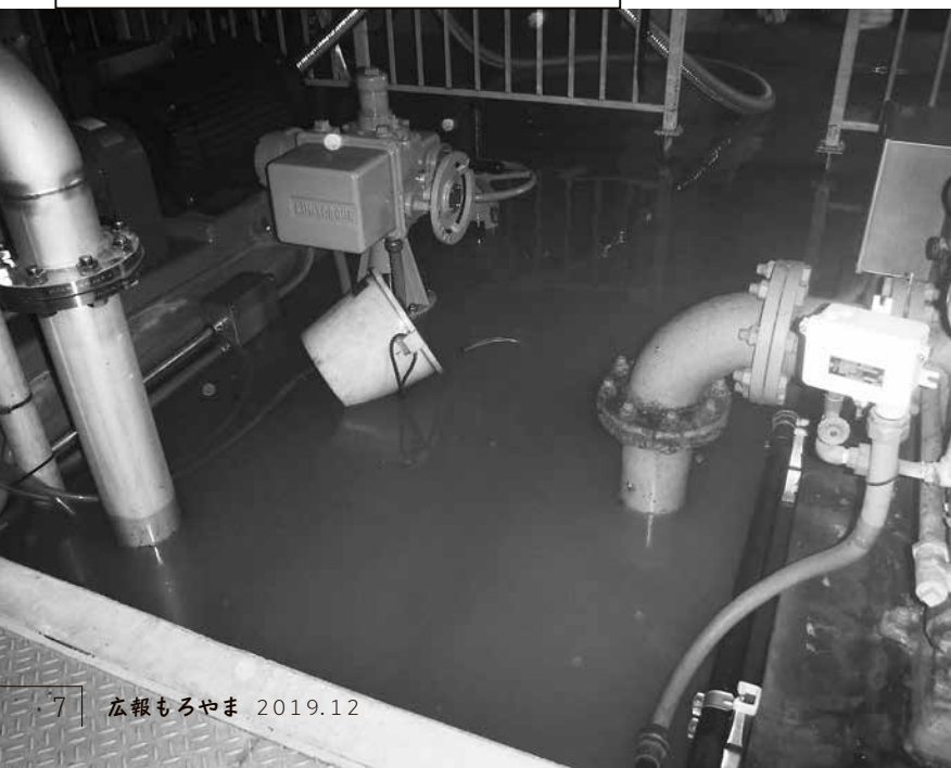
苦林浄水場冠水により機能停止(復旧済み)
