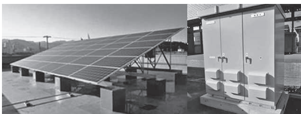
▲太陽光発電システム
