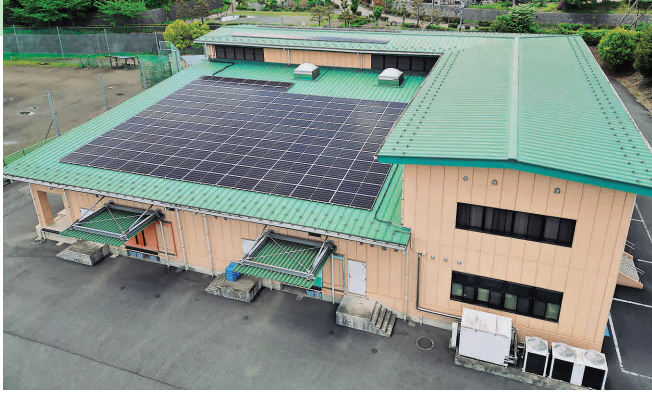
↑スマートシティ事業で学校給食センターに設置した太陽光パネル
