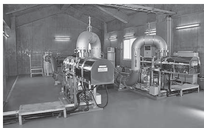
〈苦林浄水場 紫外線処理施設〉
