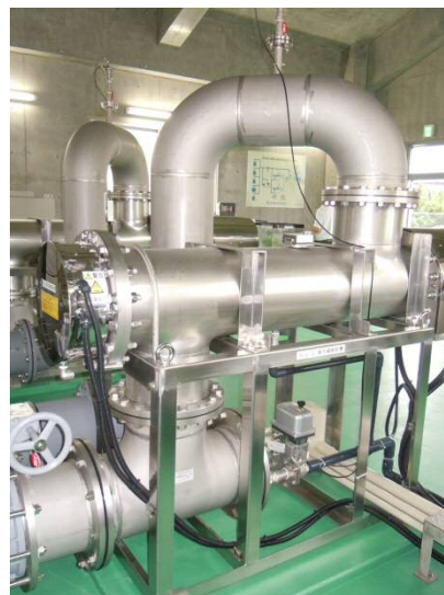
< 苦林浄水場紫外線照射設備 >
