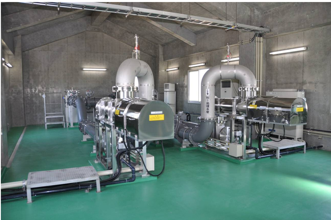
紫外線処理装置（苦林浄水場）
