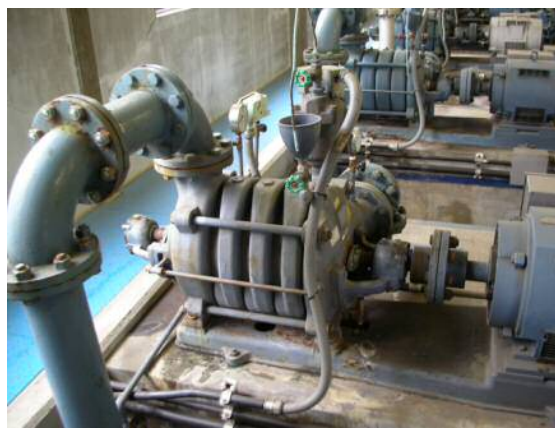
<苦林浄水場ポンプ設備>
