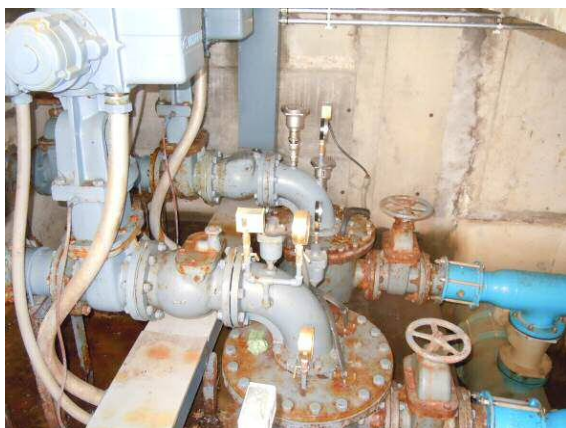
<低区配水場ポンプ設備>
