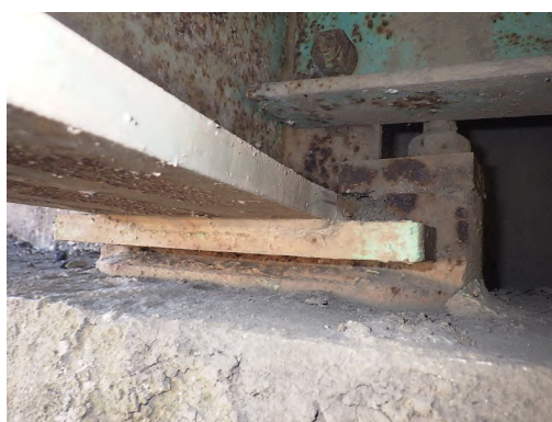
支承【塗替え前】
