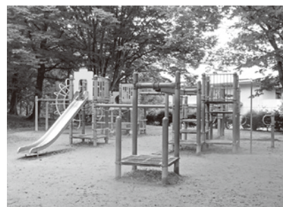
老朽化が進む遊具
