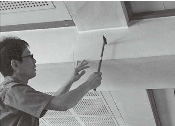
毛呂山小学校天井(クラック)の状態
