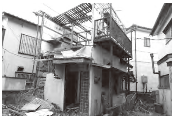
倒壊危険空家、住環境整備と早急な対策必要
