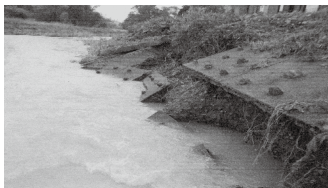
台風19号の被害(平山地区)
