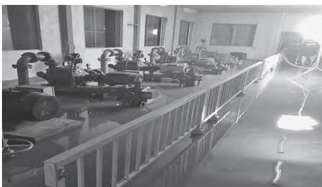
このポンプが水没していたら…
