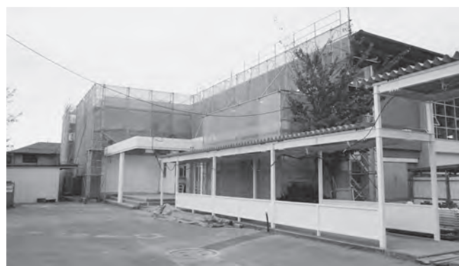
工事が中断している毛呂中体育館工事
