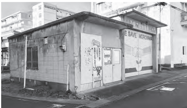
ブロック積みで耐震面も心配な分団詰所
