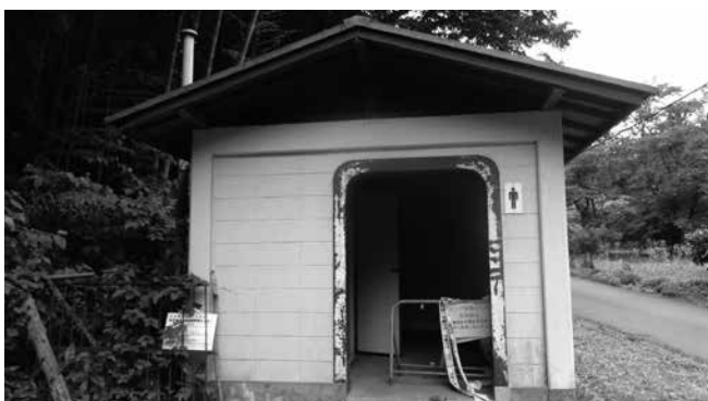
現在も使用禁止中の鎌北湖第2駐車場トイレ
