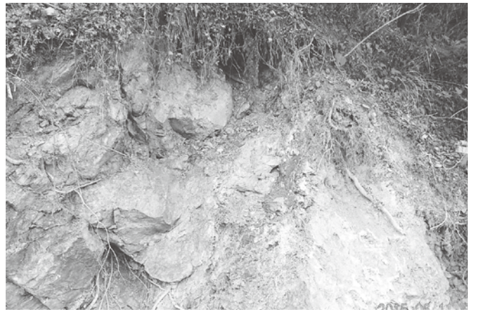
阿諏訪地区の土砂崩落現場
