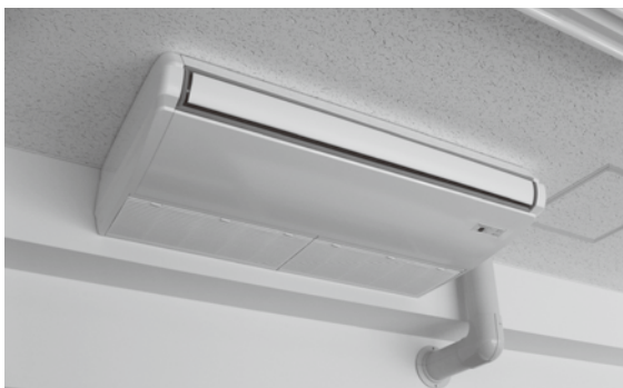
平成26年度に設置した空調機器(川角中学校)
