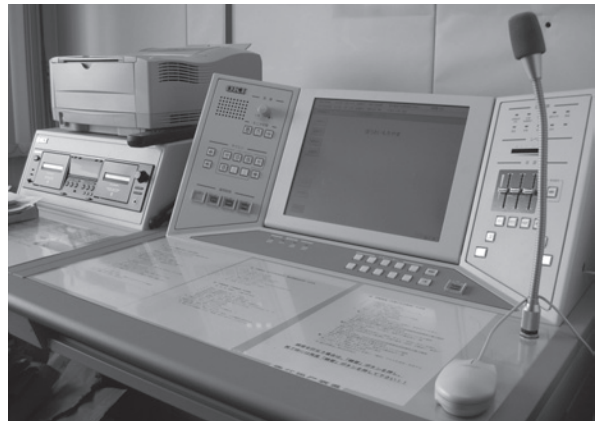
デジタル化に予定される防災無線システム
