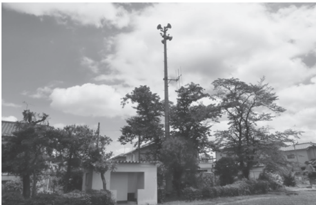
双方向通信可能なデジタル化へ(現行のパンザマスト)
