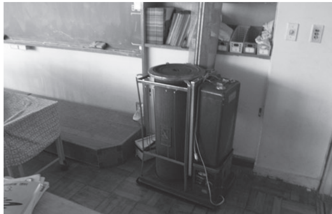
暖房を鑑み、早期にエアコンの設置を
