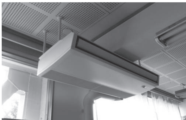
小学校の普通教室にもエアコンの設置を切望する!
