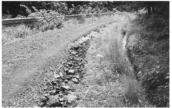
道路中央に大きな溝（林道阿諏訪線）
