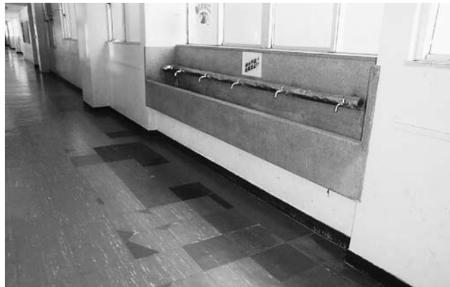
水が出せない蛇口と修理されたピータイル
