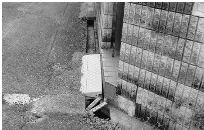
早く改修が待たれる側溝未整備箇所
