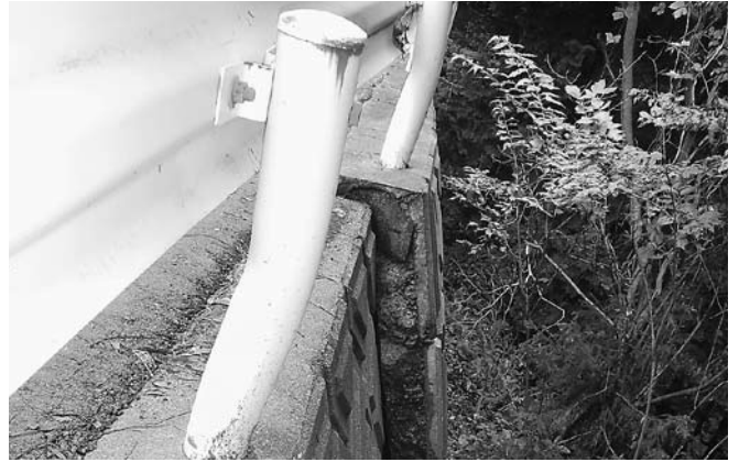
権現堂・林道中野線の崩壊が危惧される擁壁
