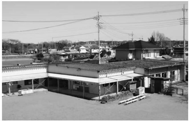
赤さびだらけの屋根、老朽化が進む上町保育園
