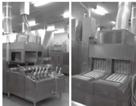
学校給食センターの各種厨房機器
