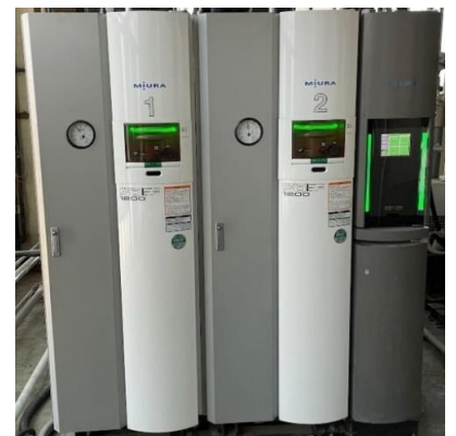
LPガスボイラー
