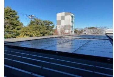
印刷工場の屋根に設置した太陽光発電
