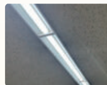
毛呂山町役場庁舎のLED照明
