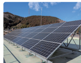
役場に設置された太陽光パネル
