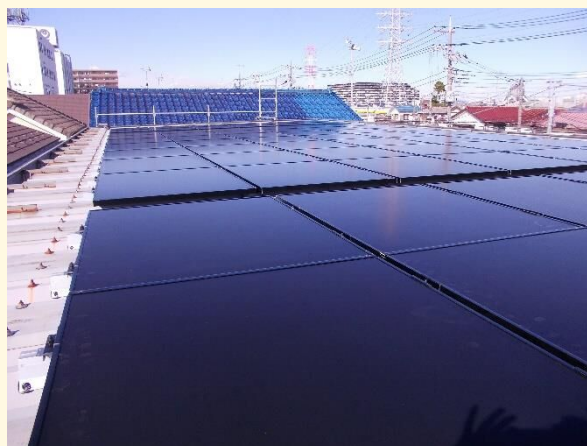
屋根に設置した太陽光発電設備（三郷 CKTC）
