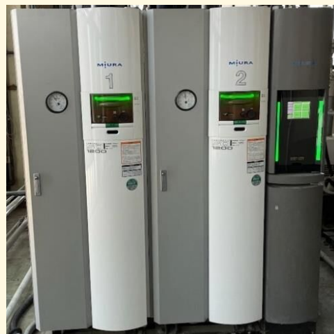
LPガスボイラー
